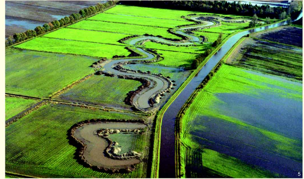
5 「自然開発」という名のもと、河川をふたたび蛇行させる工事は、文化遺産への新たな脅威となっている。
